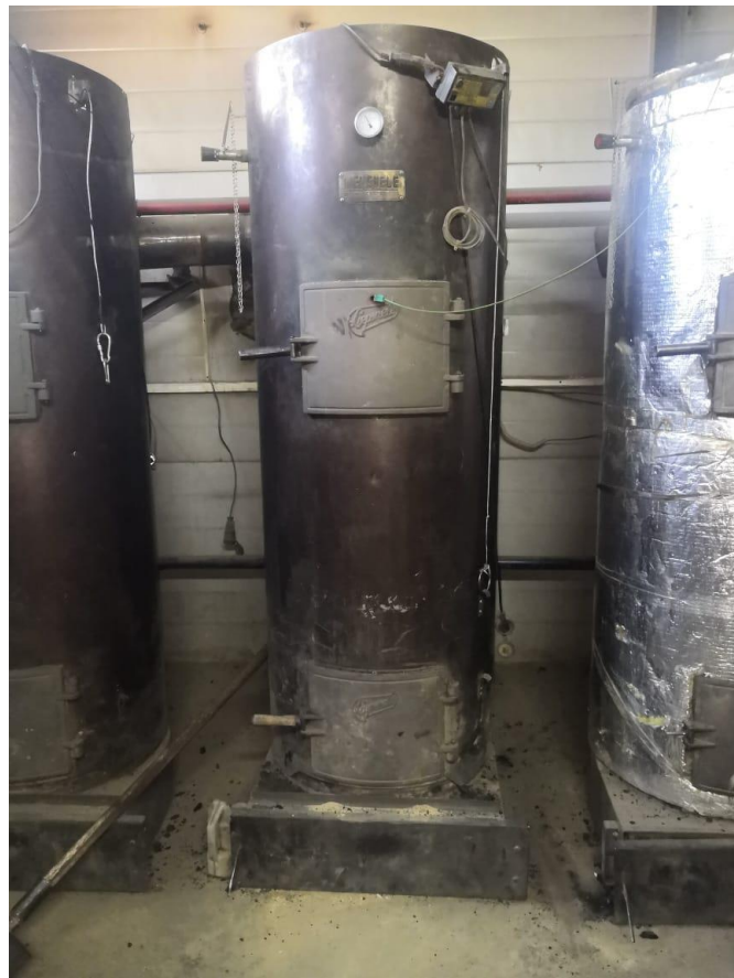
Рисунок 4.2 – Испытуемый котлоагрегат с измененной конструкцией топочной камеры
